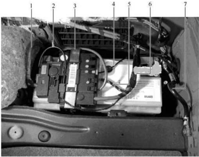
图 2-24 免维护蓄电池及其安装位置
